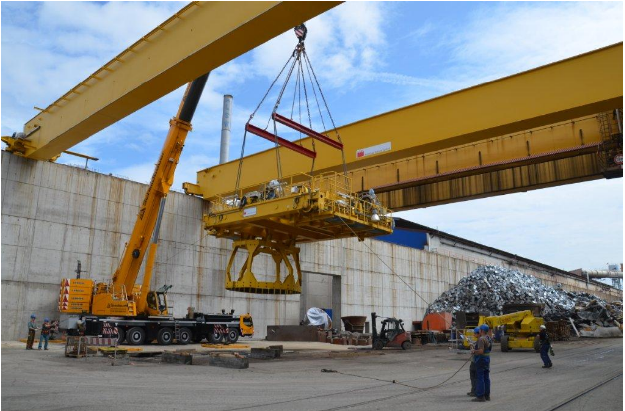
Bild 03: Nach den Kranbrücken folgte die Krankatze am Mittag an Ihren Bestimmungsort auf dem Schrottplatz der LSW. Auch hier war Maßarbeit mit dem 75 Tonnen schweren Bauteil gefragt.
