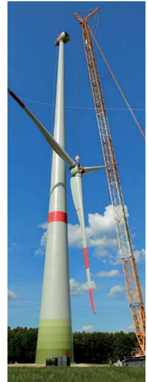
Mit einem riesigen Kran wird der Rotor dann in schwindelerregende Höhen gehoben und am Maschinenhaus, welches den Generator beinhaltet, montiert.
