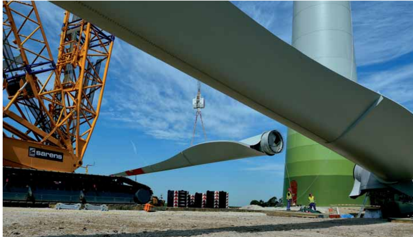
Nachdem Fundament und Turm aufgebaut sind, werden die Rotorblätter zur Montage an der Nabe vorbereitet.
