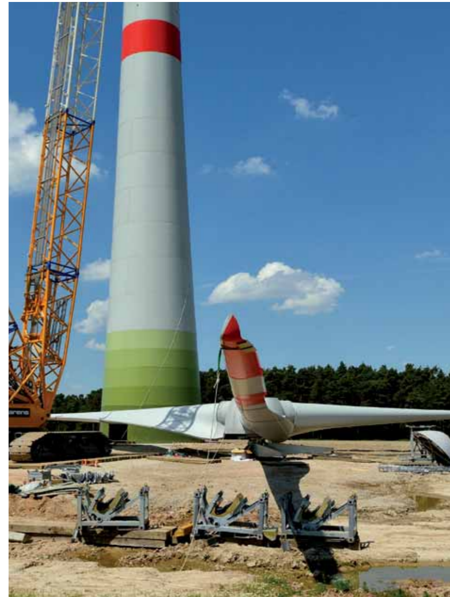
Das fertige Bauteil aus Rotorblättern und Nabe hat ein Gesamtgewicht von mehreren hundert Tonnen und muss anschließend in einem Stück am Turm montiert werden.
