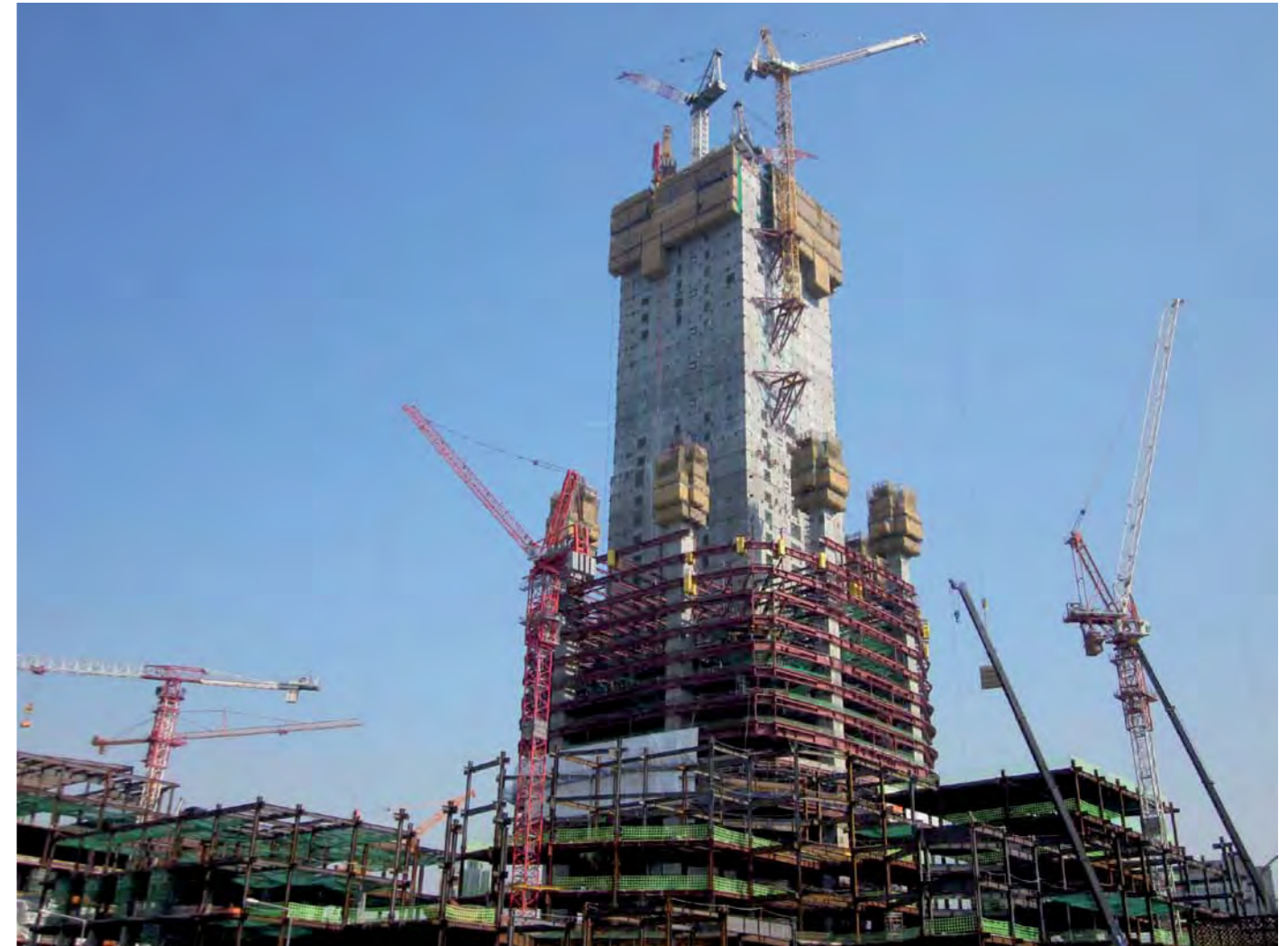
Für die Vertikal- und Längsbewehrung in den insgesamt acht Megastützen des 555 Meter hohen Wolkenkratzers liefert das Stahlwerk Annahütte mehr als 600 Tonnen SAS Gewindestahl und rund 8.150 Gewindestahlmuffen.
