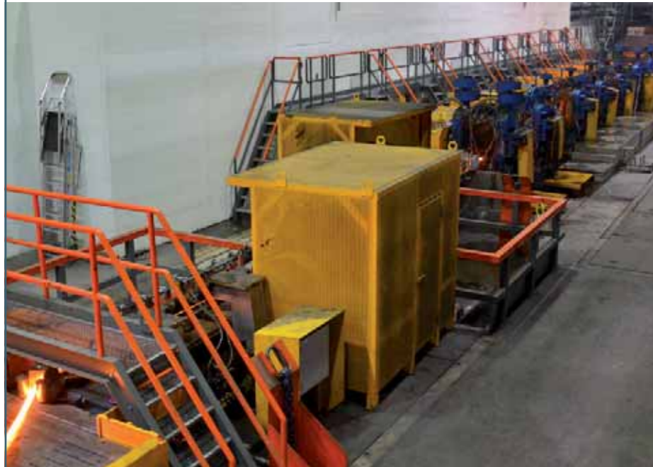
10 | Die neue Walzstraße 1 der Lech-Stahlwerke ist in Betrieb
